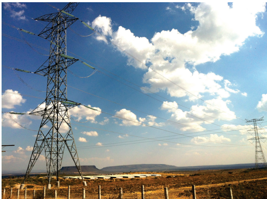
Línea de transmisión eléctrica de 400 kV.
